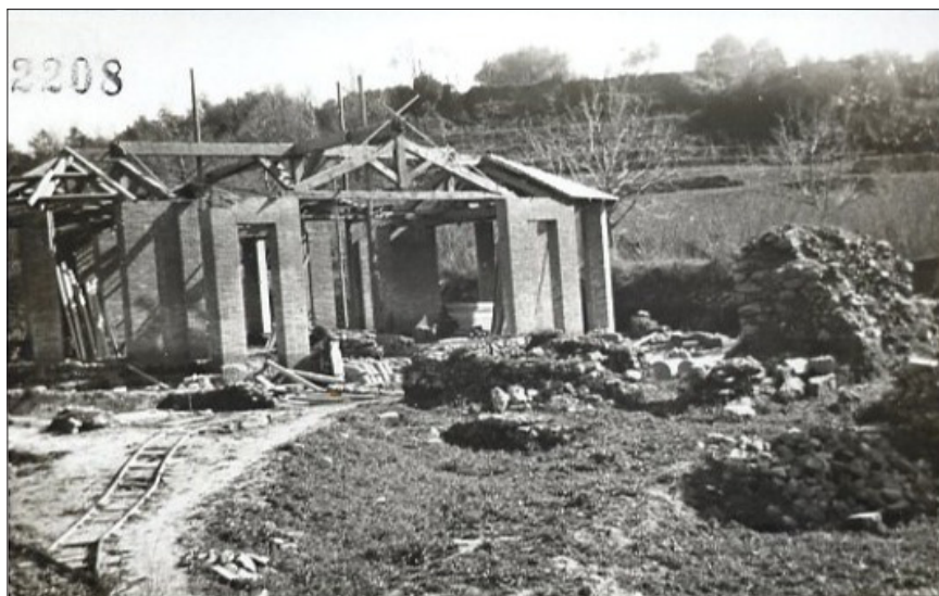
Fig. 8. 1941-1942, la copertura del triclinio progettata da P. Gazzola in fase di costruzione (Soprintendenza per i Beni Culturali e Ambientali di Enna).
